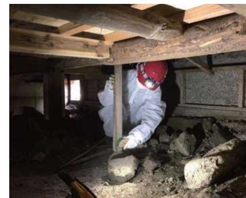
7月豪雨災害被災地での活動のようす(広島県) 床下の土砂出し、清掃、消毒作業を丁寧に行っています。
